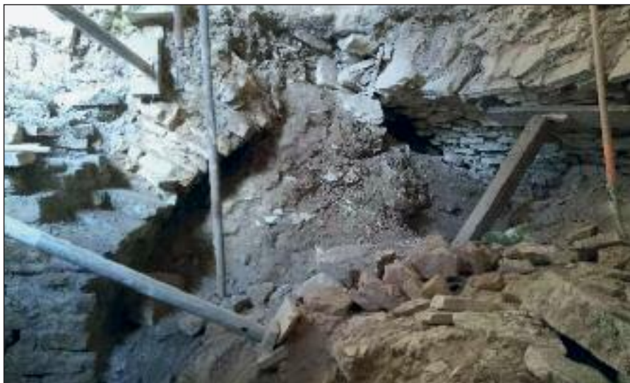
Propadlý jihovýchodní sklep
