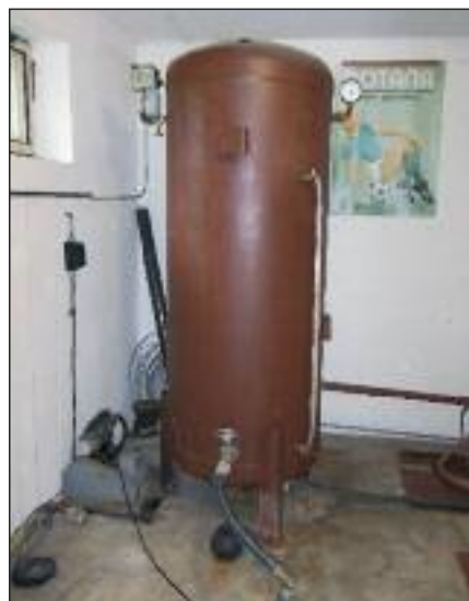
Tlaková nádrž a čerpadlo byly po 36 letech vyměněny
