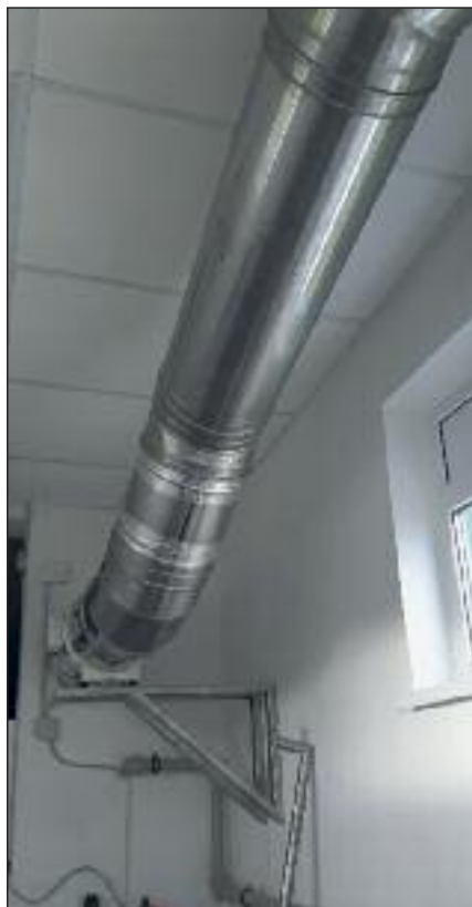
Odtahové potrubí ve vodojemu
