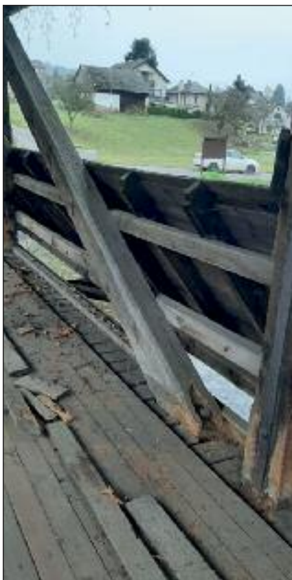
Nenávratně poškozené nosníky dřevěné lávky
