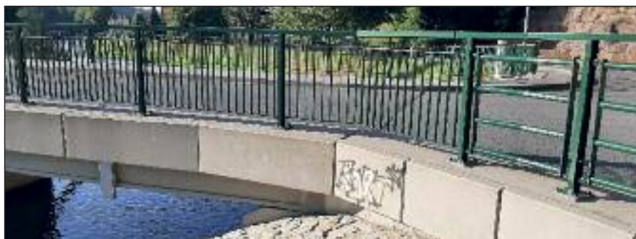
Poškození mostu Ve vsi sprejery
