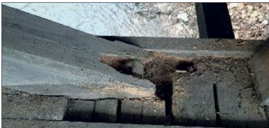
Detailní pohled na poškozenou mostovku a nosník lávky
