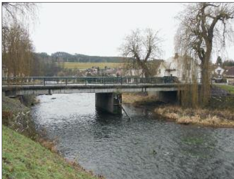
Pohled na betonový most ve Vsi, který čeká kompletní oprava
